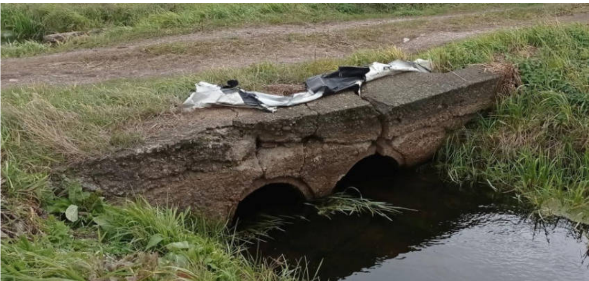
Ryc. 39. Przepust okularowy w złym stanie (fot. Sz. Chmur).
